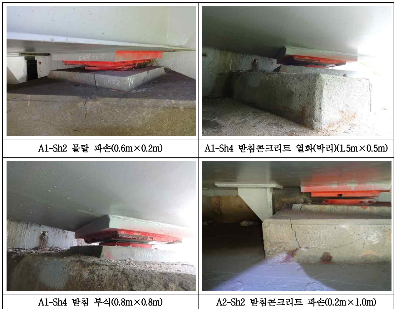
【사진 3.38】교량받침 손상현황
