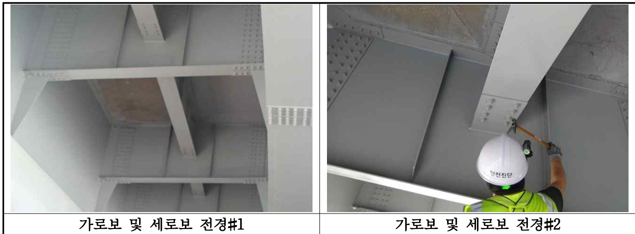
【사진 3.7】 가로보 및 세로보 손상현황
