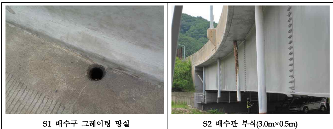
【사진 3.47】 배수시설 손상현황
