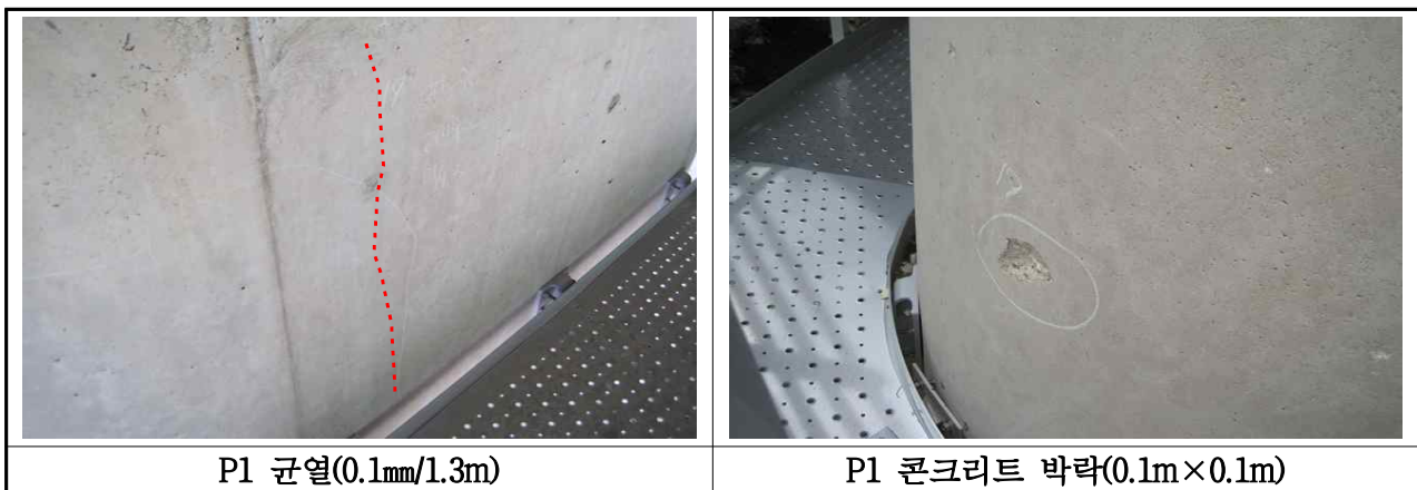
【사진 3.36】 교각 손상현황
