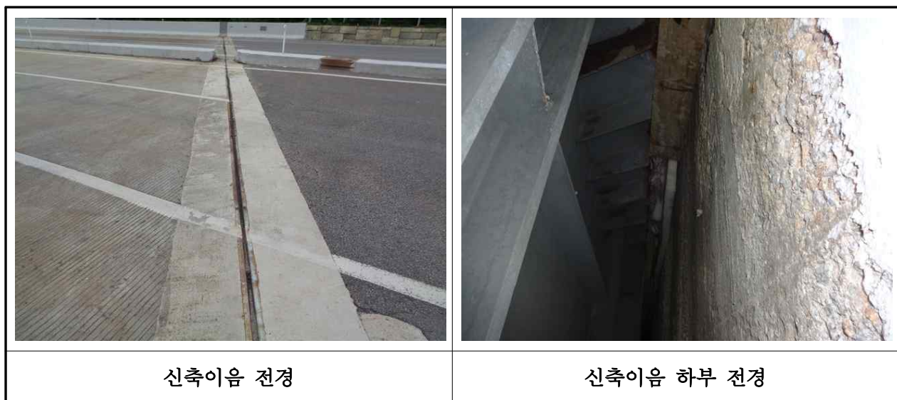
【사진 3.42】 신축이음장치 손상현황
