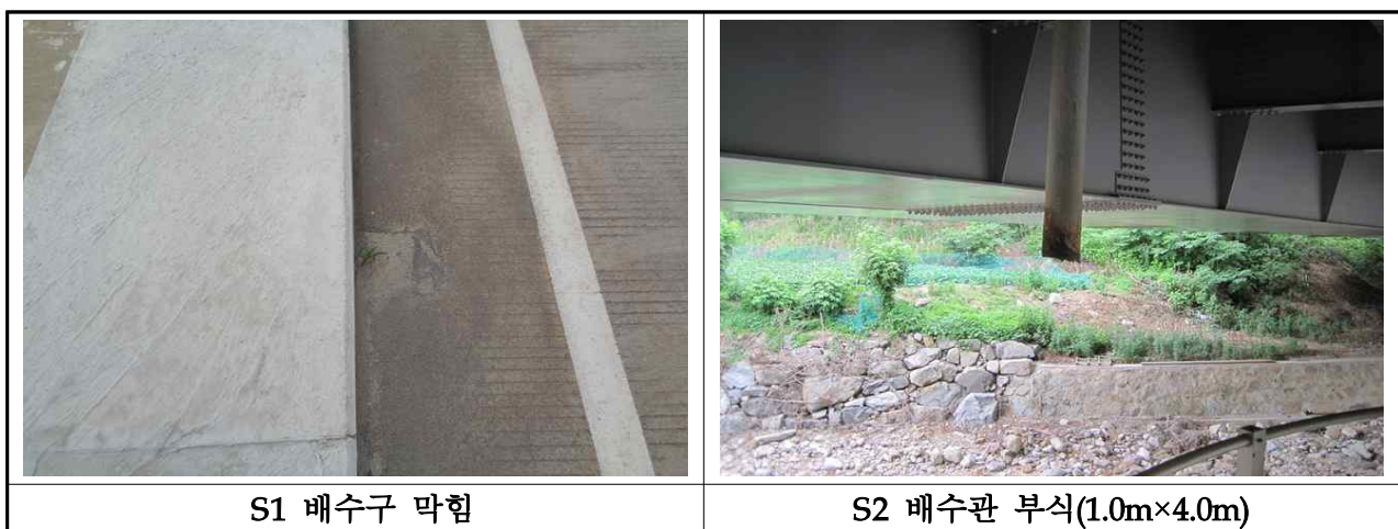
【사진 3.23】 배수시설 손상현황
