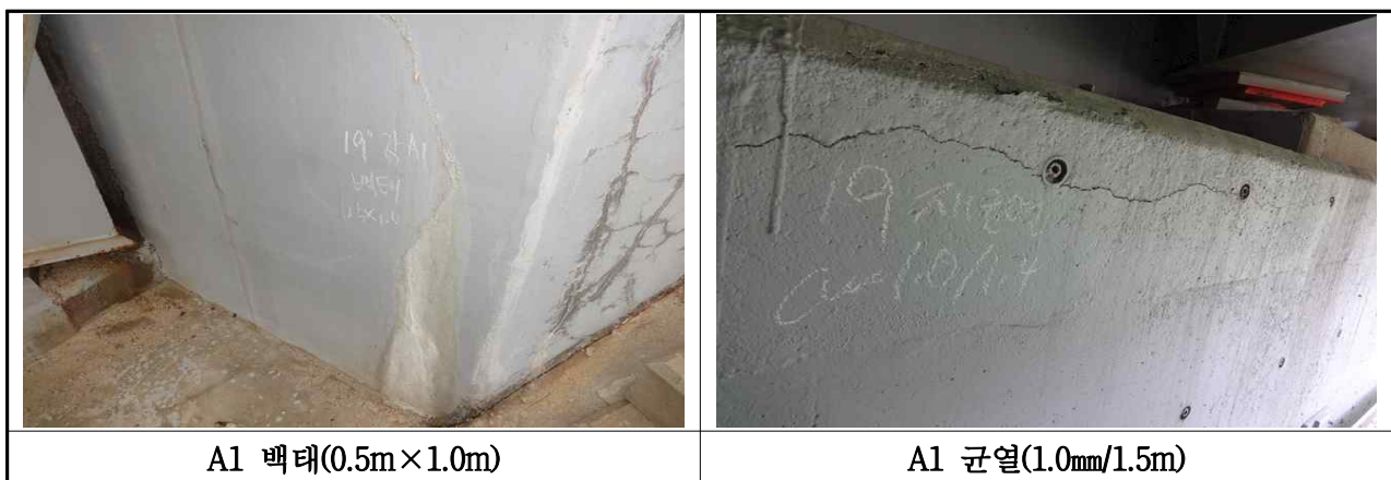
【사진 3.35】 교대 손상현황
