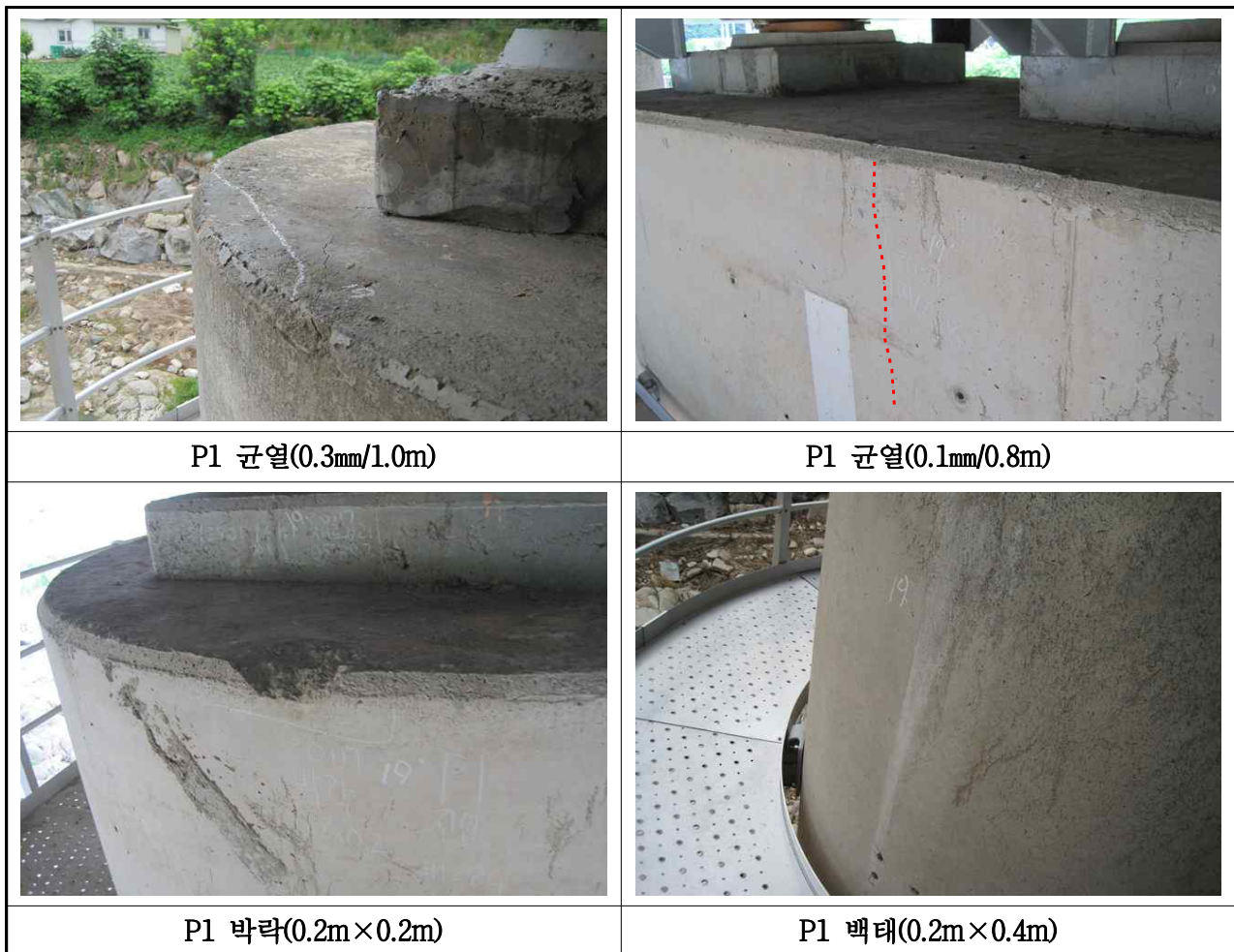
【사진 3.12】 교각 손상현황
