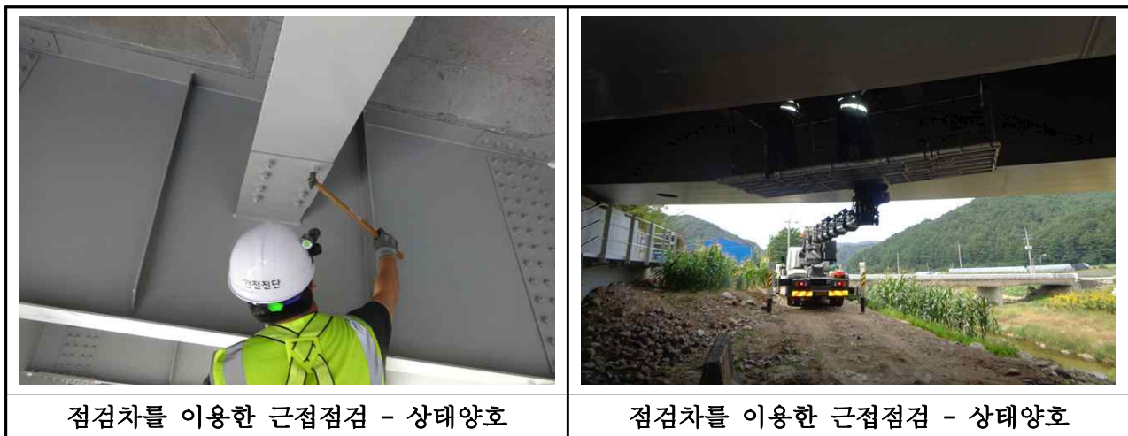
【사진 3.33】 가로보 및 세로보 손상현황
