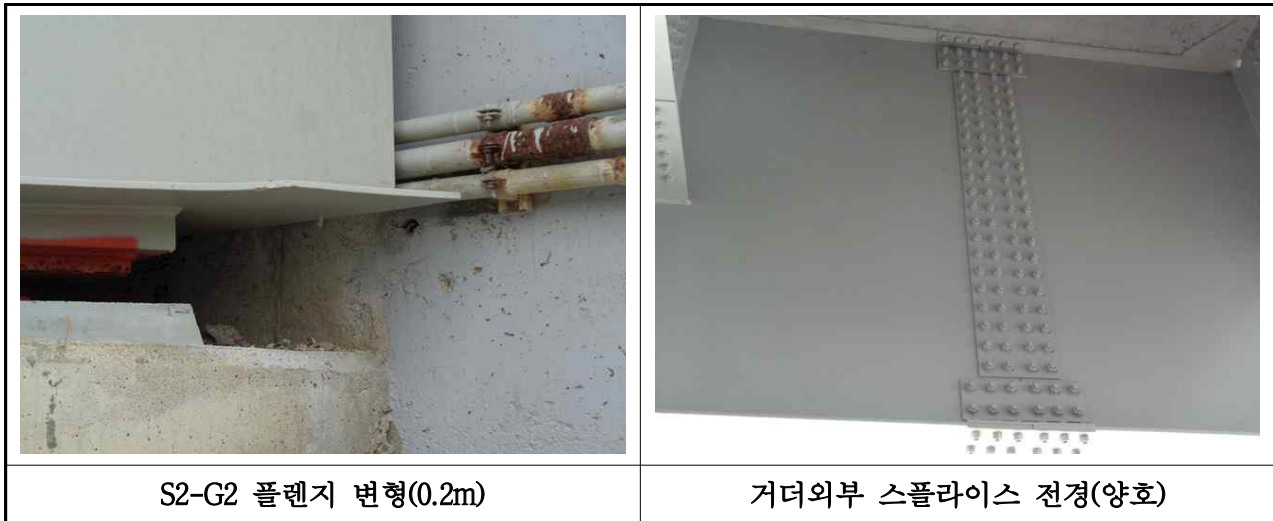
【사진 3.5】 거더 외부 손상현황
