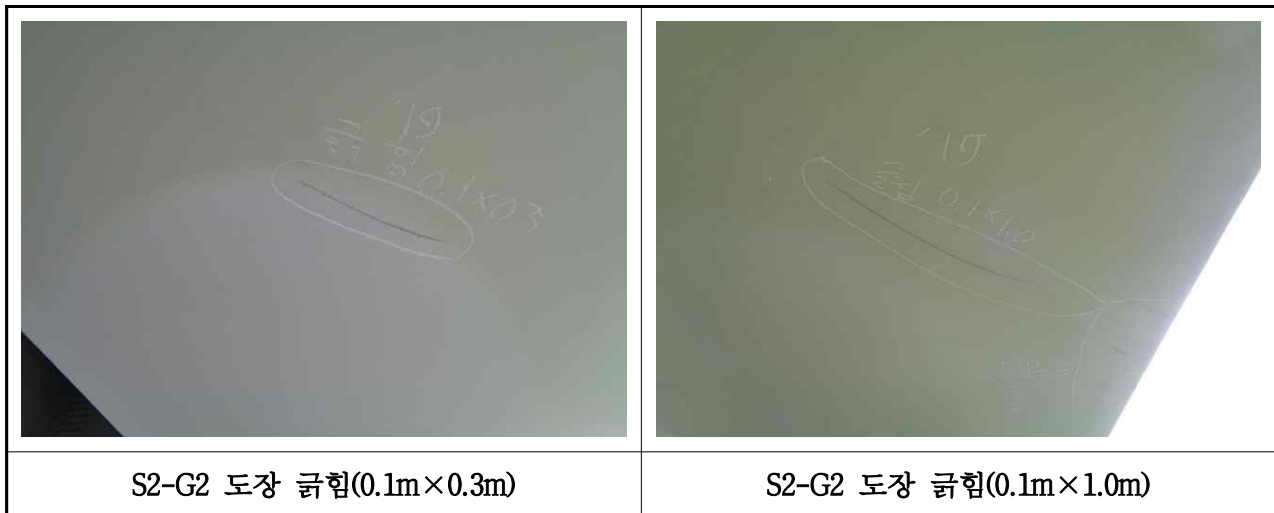
【사진 3.30】 거더 외부 손상현황
