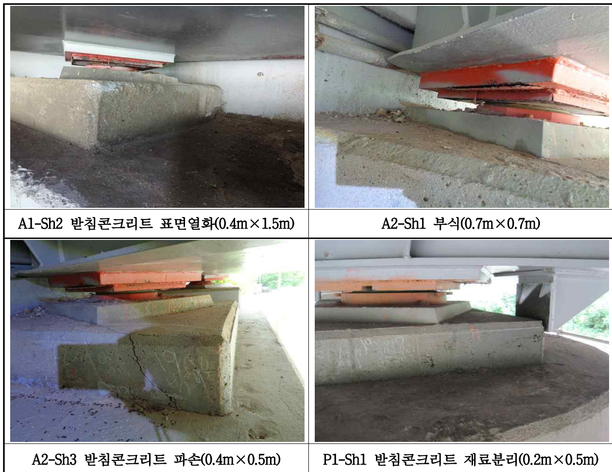
【사진 3.14】 교량받침 손상현황
