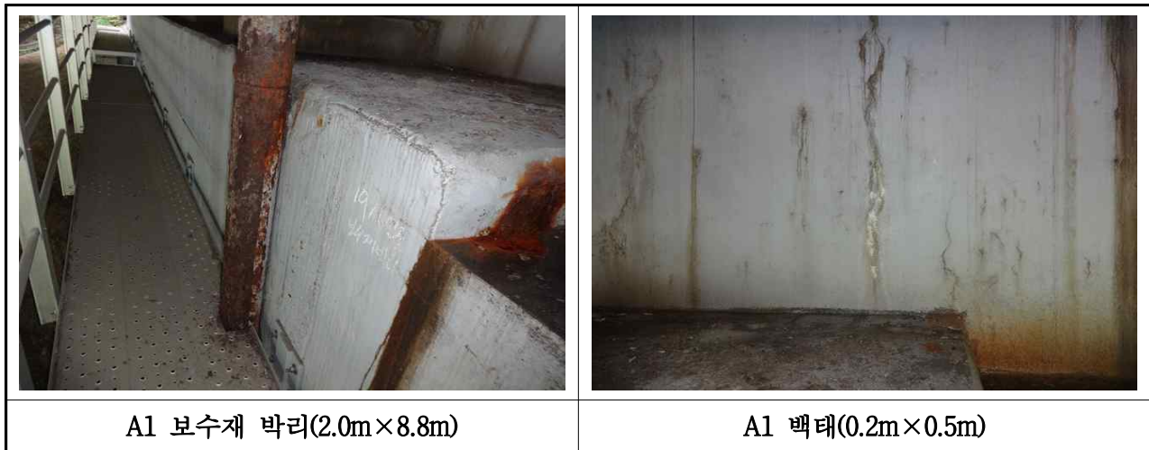
【사진 3.10】교대 손상현황
