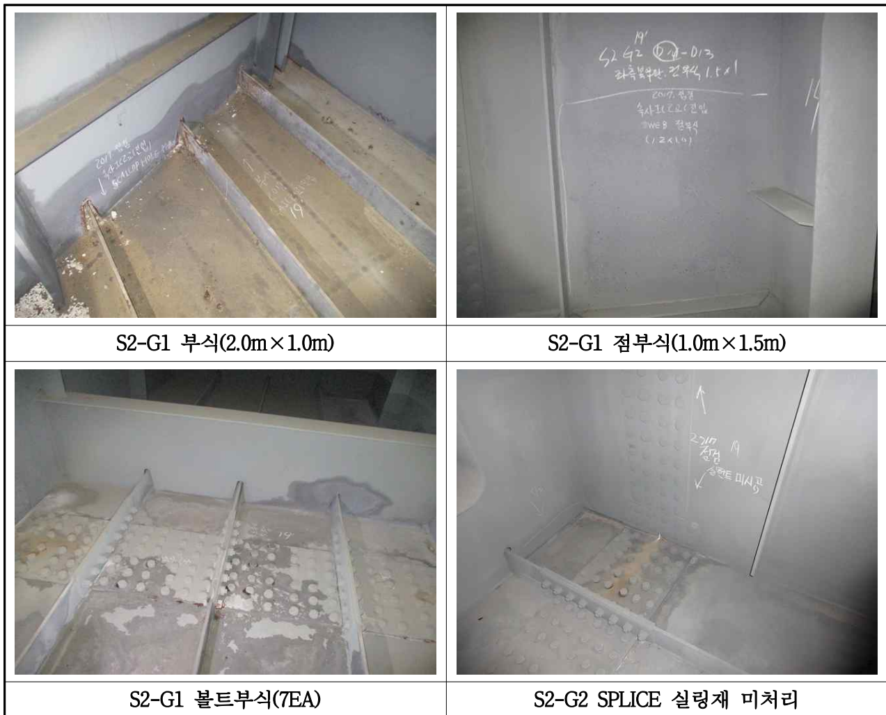
【사진 3.6】 거더 내부 손상현황
